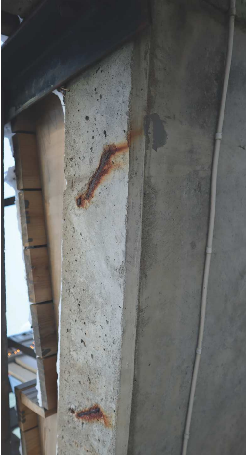
Betonin raudoituksia on näkyvissä.
